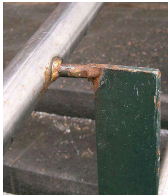
Sähkökemiallinen korroosio ulkoportaan kaiteessa
