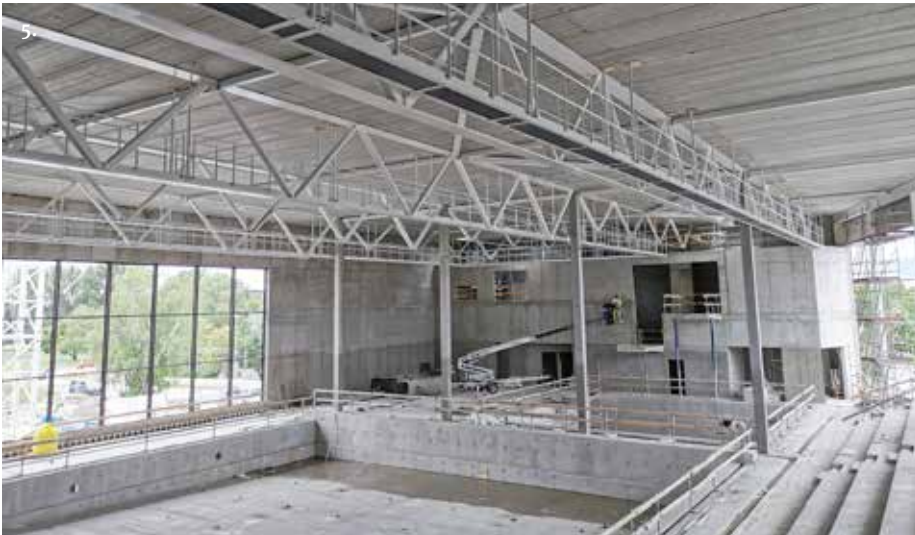
Kuva 5: Karin uimahallin WQ-ristikot ja huoltosillat.
