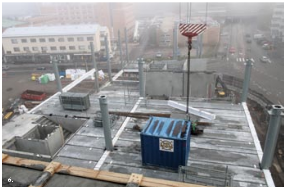
Kuvat 4 ja 5: Nordecin ja Nordecille tuoteosakaupan suunnittelun tehneen Swecon ehdotuksesta alakerosten runko muutettiin sekarungosta teräsrungoksi. Isoilla liittopilareilla ja hitsatuilla WB-kotelopalkeilla saatiin esimerkiksi järjestetyksi järkevasti jäteautojen ajo jätetilaan ja liikkuminen siellä.
